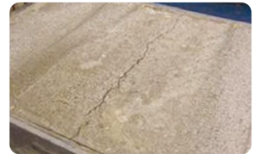
Typisch scheurpatroon in standaard beton
